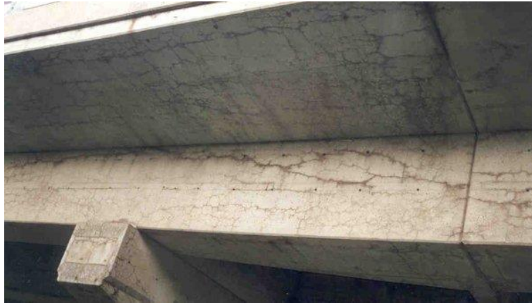
Figuur 1.1 Schadelijke ASR in een viaduct.
